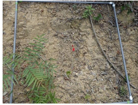
写真 2. 保護ネットの無い法面
