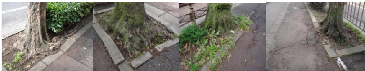
写真—1 根元あふれ 写真—2 縁石ずれ 写真—3 歩道持上げ 写真—4 歩道ひび
